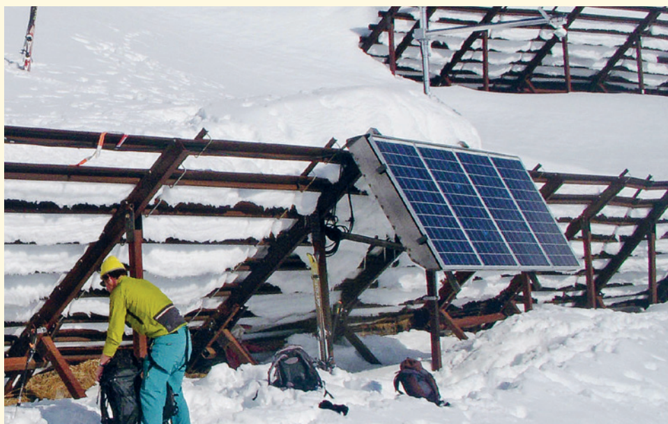
L'une des quatre installations solaires d'essai sur des paravalanches à St. Antönien (GR). Sur le tablier para-neige situé derrière les modules solaires s'est accumulée de la neige supplémentaire – un risque potentiel pour la sécurité.
