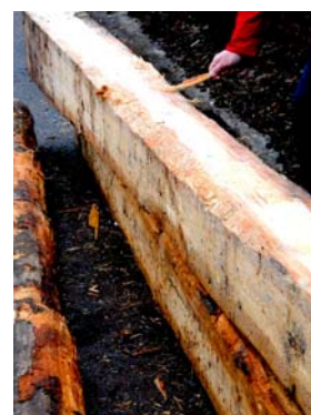
Fig. 2: Bois de sciage endommagé
