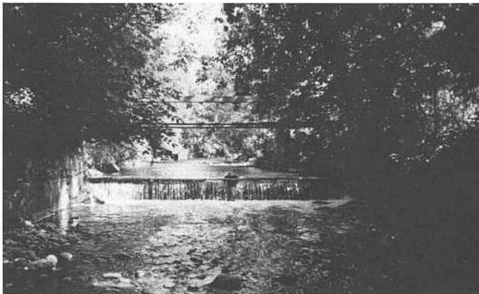
Abb. 9-19: Absturz beim Schwimmbad Möriken
